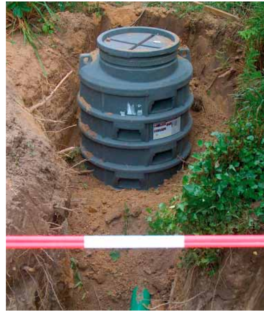
Eingebauter Hauskontrollschacht aus PE-HD.
