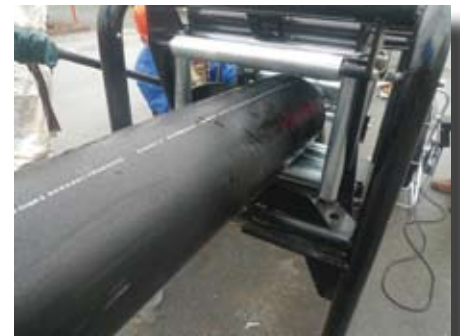
Die Verformung des PE Rohres beginnt mit dem Einzug in die Rollenführung.
