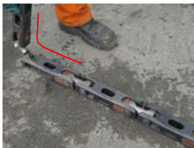
Beim Einzug durch den Schacht ist ein gelenkiges Gestänge erforderlich, das Bögen bis 90° ermöglicht. Dieses
