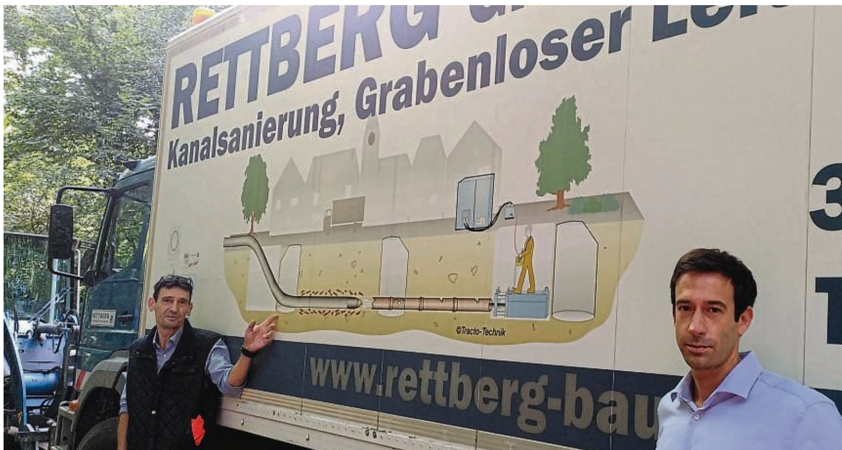
So geht es: Bauleiter Thomas Hess (links) erklärt, wie die Firma Rettberg im Schedetal die neue Abwasserleitung verlegt. Eine Grafik auf der Lkw-Wand zeigt, wie das ohne umfangreiche Baggerarbeiten funktioniert. Bürgermeister Tobias Dannenberg besichtigt die Baustelle. FOTOS: KIM HENNEKING
