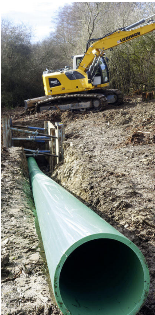
Rohrstrang im Mindersbacher Tal
