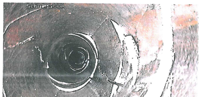
Ein problemloses Abfließen ist ausgeschlossen: Zustand des Teilstückes in der Schulgasse im Jahr 2012.
